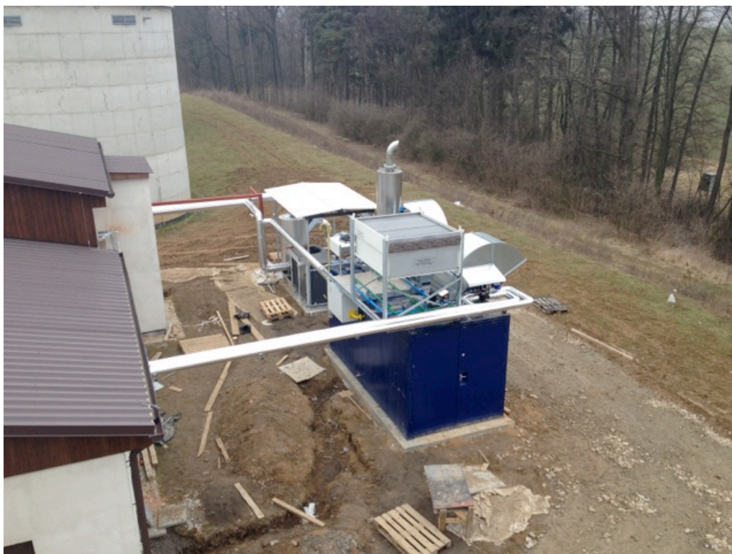
Kogenerační jednotka před dokončením
